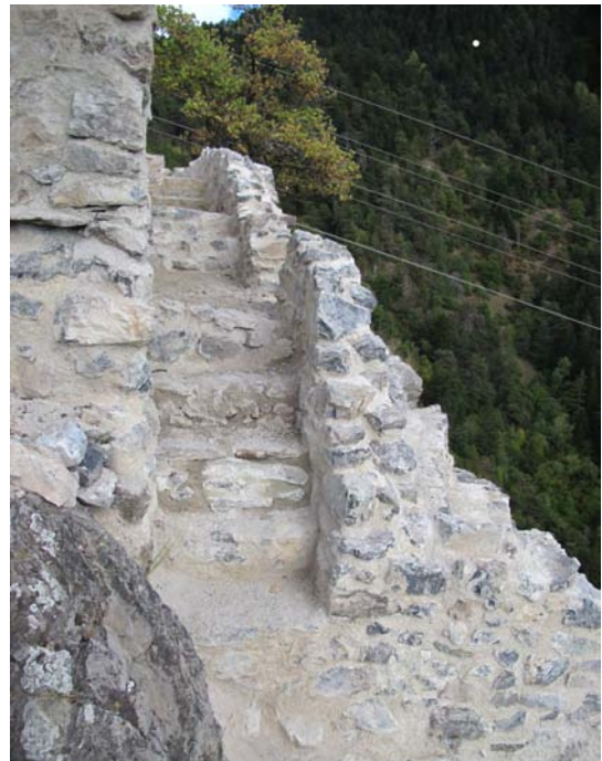
Fig.23 Le couloir (G) menant à la poterne à la fin des travaux 2011.
